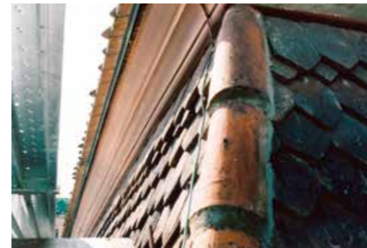
Abb. 6: Detailaufnahme Dachbruchbereich, Nachzustand mit eingemörtelten Gratziegeln und Abtropfblech oberhalb der Holzabschlüsse. Foto: Castor Huser, Baden
