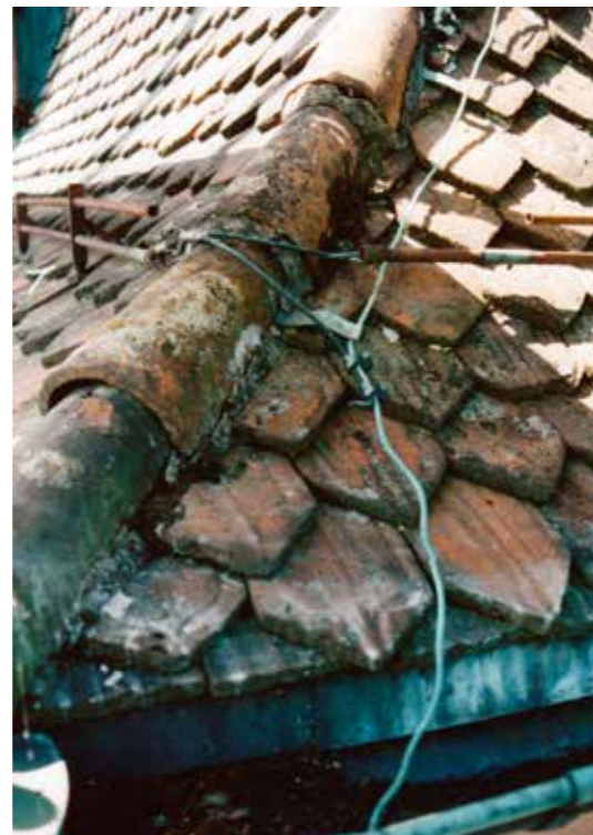
Abb. 3: Zustand des Daches vor der Restaurierung. Foto: Castor Huser, Baden
