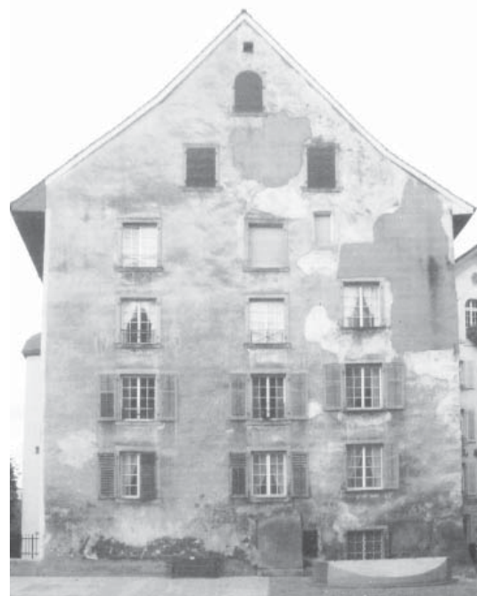
Abb. 1: Nordfassade. Zustand vor der Restaurierung. Foto: Kantonale Denkmalpflege Aargau
