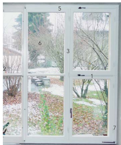
Abb. 8: Musterfenster. Bei rechtem und mittlerem Flügel sind die Innenscheiben durch IV-Verglasung ersetzt. Trakt 1, Ostfassade, Erdgeschoss.
