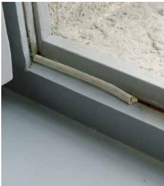
Abb. 5: Eingefräste Dichtungen bei den Innenfenster- rahmen. Südfassade, Erdgeschoss, Raum Nr. 11.
